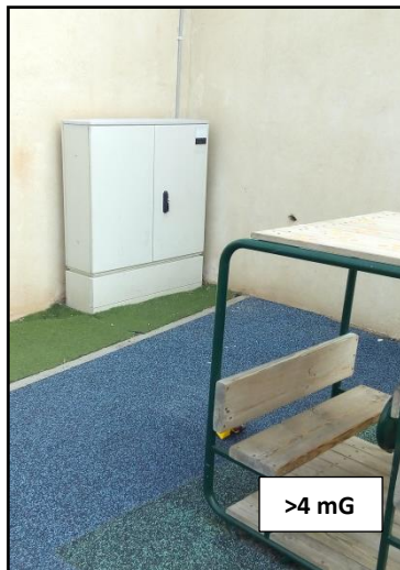
>4 mG על מתקן שעשועים שבחצר גן הנמצא בקרבת לוח חשמל ראשי בפינה
